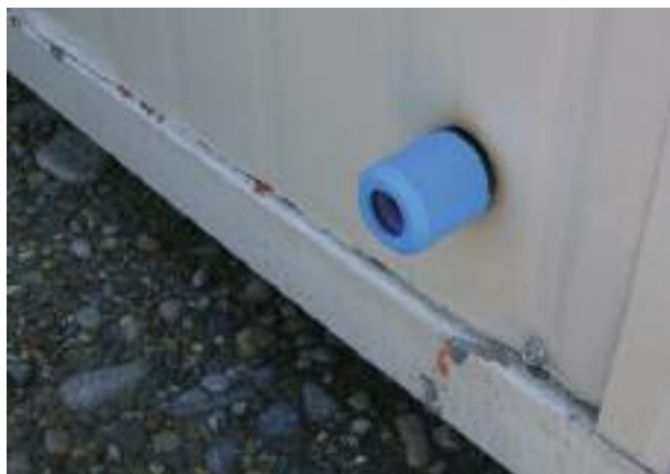
Raccordement pour alimentation en eau sur bungalow de chantier
